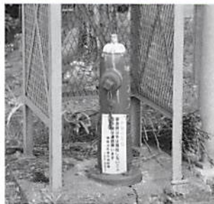
白ペンキを塗られた消火栓 早期改善を
