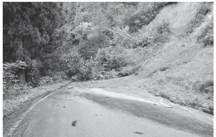
芝原三俣線、土砂崩れ現場
