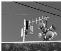
消防サイレン吹鳴スピーカー
